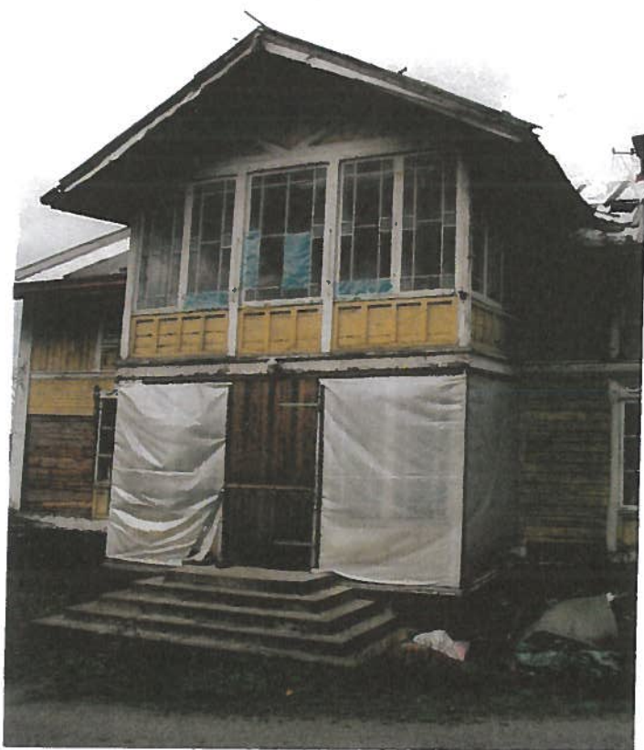
På våren 2002 startade restaureringen av "Gula villan" på Överjärva Gård i Solna norr om Stockholm. Den siste hyresgästen hade flyttat ut sex år tidigare. Huset hade då förfallit under många år och knappt sett något underhåll det senaste halvsekle.
