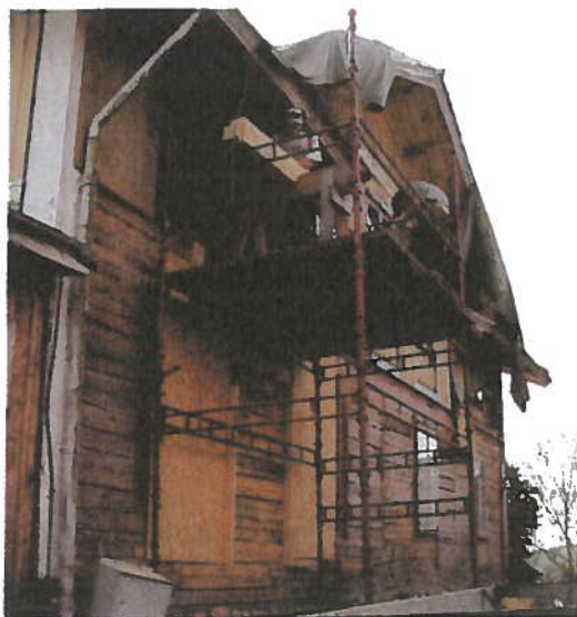
Den avklädda timran får nytt friskt timmer. Lagningar gjordes med ti som fått torka i två år. Panelen kunde sedan återmonteras med den ursprungliga smidda spiken.
